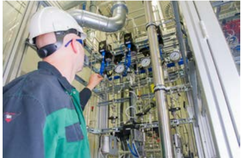
Upstream-Rack der Pilotanlage zur Methanolsynthese aus Synthesegas
