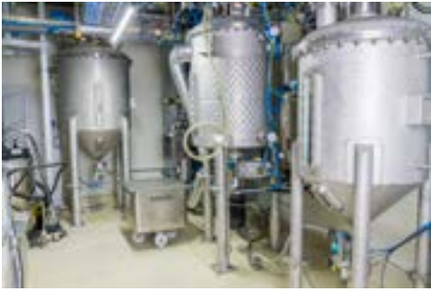
Dispergier- und Vorlagetanks für Rapsaufschluss und Konditionierung
