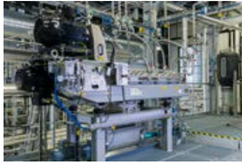
Dekanter für die Abtrennung der Feinst- und Schwebstoffe
