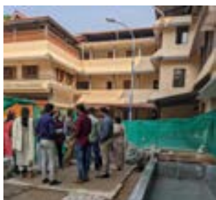
Fassung für die naturnahe Abwasserreinigung an der Government Higher Secondary School in Kochi
