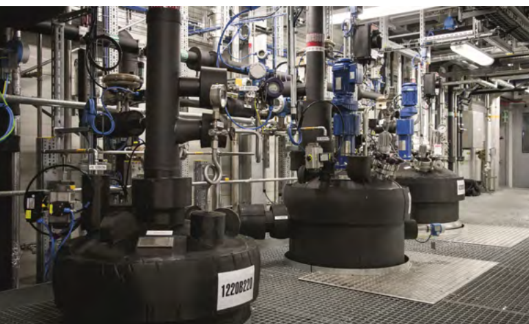
Behälter für die Fällung von Lignin aus der Kochlauge
